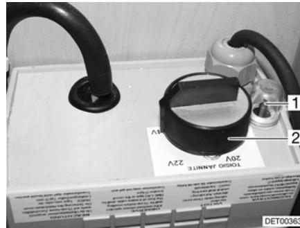
Kuva 89 Sähköisen lattialämmityksen säädin
